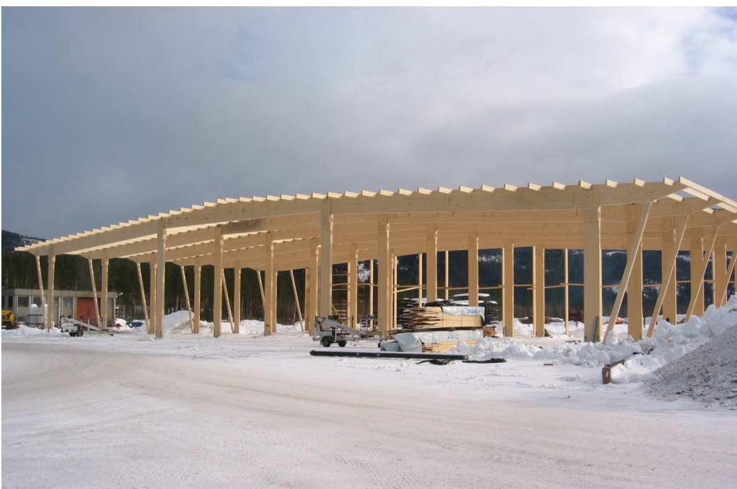
Lagerhall for trelast, Begna Bruk (Vestlandske Limtre Industrier, 2004)
